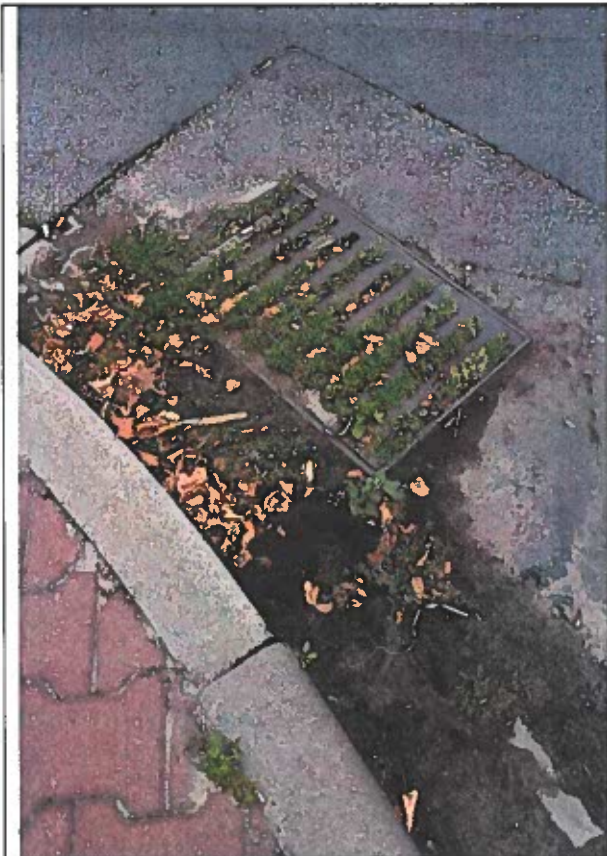
Zatkana kratka kanalizacji deszczowej w samym centrum Rogoźna - 2019.08.01
