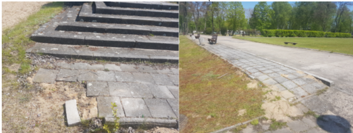
RYSUNEK 50. DOKUMENTACJA FOTOGRAFICZNA - STAN CIĄGÓW KOMUNIKACYJNYCH
